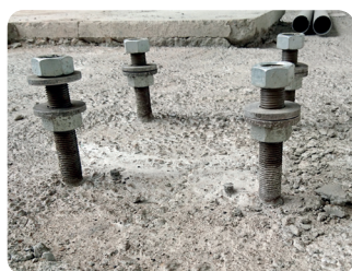
Fraguado en hormigón.
